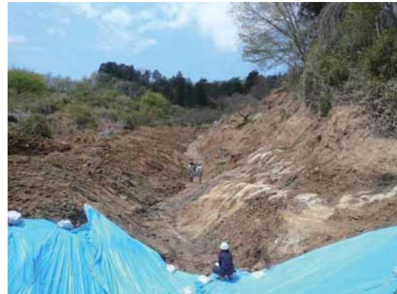
神長地区の崩壊地部、 右は栗の果樹園造成地、 崩壊部の主体は谷地形部
